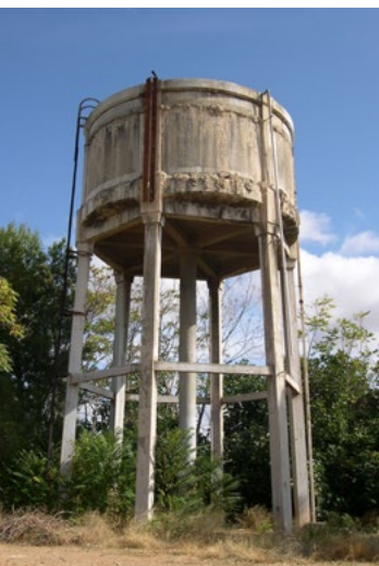
Depósito de agua de 130 m 3 de la estación de Cariñena.
