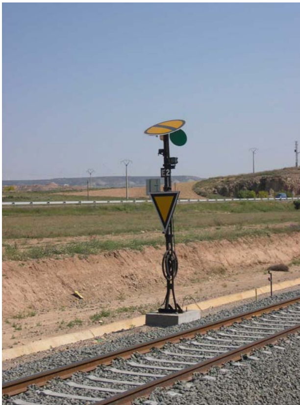
Señal avanzada lado Caminreal de la estación de Muel-Mozota, en la indicación de anuncio de precaución, situada provisionalmente a la izquierda de la vía debido a las obras en el apeadero de Arañales de Muel. Singular elemento de señalización, cuyo disco superior gira mediante un eje horizontal, característica heredada de la Compañía Central de Aragón, que ha permanecido hasta nuestros días y que irremediablemente desaparecerá con la transformación de la línea.
